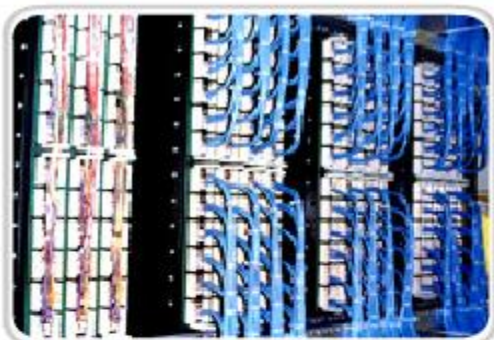
Patch panels UTP en un bastidor
