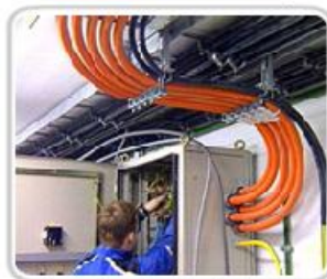
La separación entre el cableado de datos y el de energía eléctrica debe cumplir con los códigos de seguridad.
